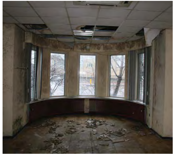
Beschimmelde vergaderruimte begane grond 2012
