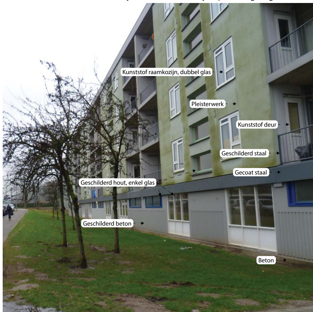
Onderhoudsproblemen. (Eigen illustratie)
